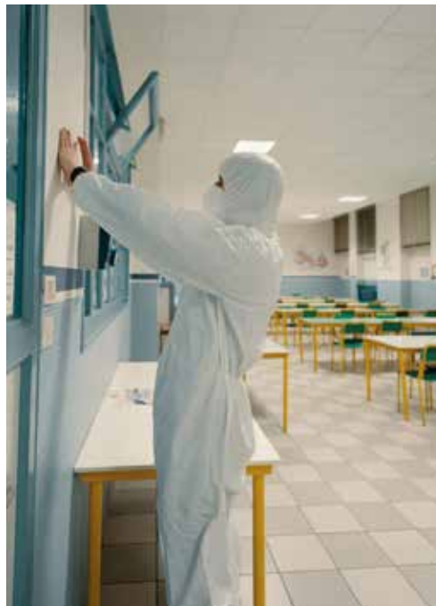
INSTALLAZIONE DEI SENSORI AIRTHINGS PRESSO UN ISTITUTO SCOLASTICO
